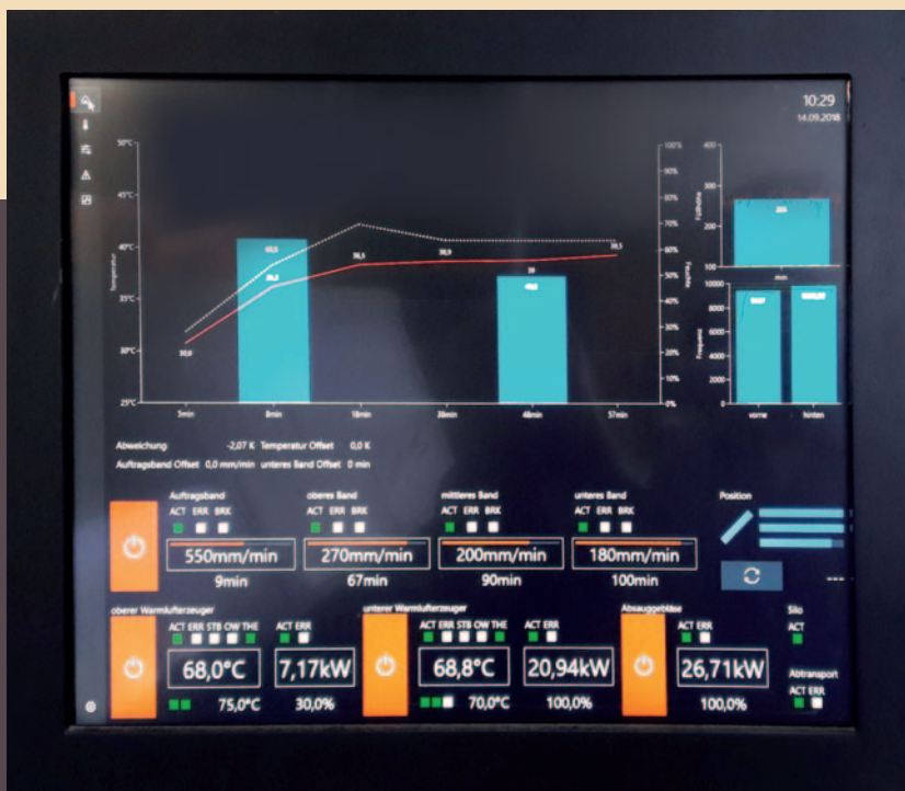
Anzeige relevanter Einstellungen und Messwerte bei der Bandtrocknersteuerung Display of relevant settings and measured values for belt dryer control
